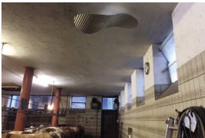
Eine GeoWave, befestigt über den Tieren im Stall.
